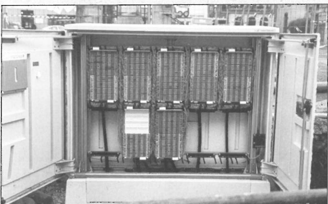
La nouvelle armoire téléphonique centrale de France Télécom pour 500 abonnés plouaysiens.
