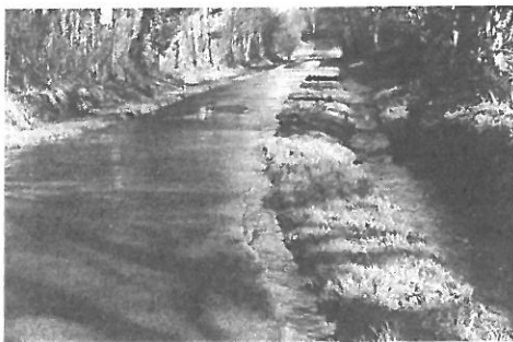
Inondations. Les chaussées gorgées d'eau.
