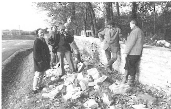
Réfection du mur d'enceinte du château de Menehouarne, en présence de Maryannick Troumelin, Adjointe au Maire.
