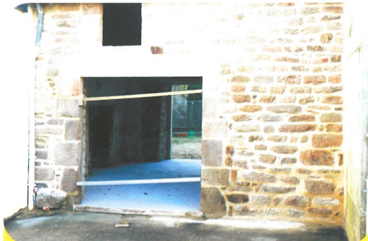
Rue du Marquis. Renovation d'une construction destinée à l'accès aux logements sociaux du CCAS de la rue de la Justice et à la création d'un local de dépôt pour conteneurs du tri sélectif
