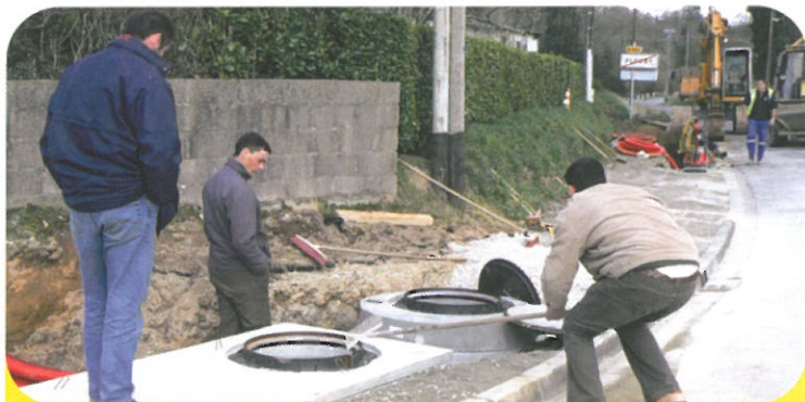
Installation d'une chambre de chloration (Communauté de Communes) pour une meilleure qualité de l'eau de desserte en direction de Lanvaudan
