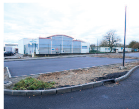
Le parking situé devant la gendarmerie a été aménagé et un nouveau parking a été créé entre celui-ci et le gymnase, offrant des places supplémentaires fort appréciées.
