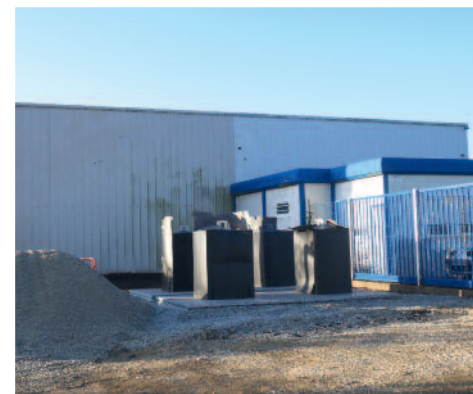
Les containers à verre et à papier enterrés ont été posés près des services techniques.
